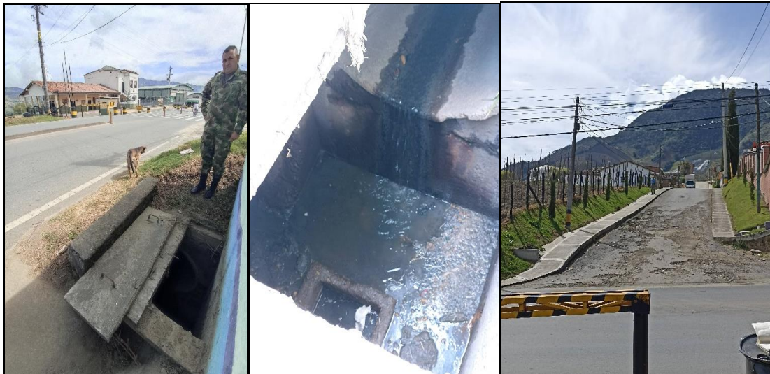
Box Coulvert que comunica la Calle 20 con la proyección de la misma, hacia el nacimiento y predios abajo
