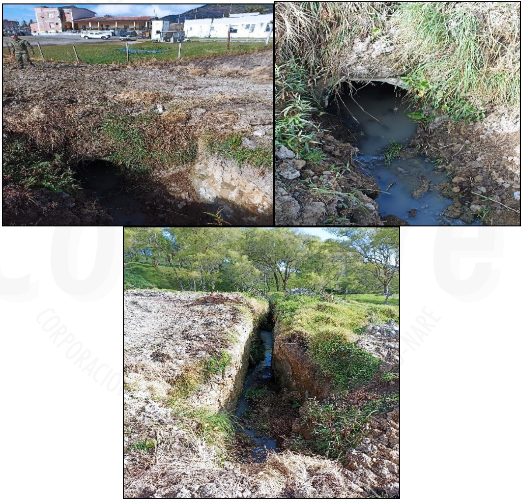
Punto de vertimiento al arroyo y aguas abajo – Alcantarilla que deposita las aguas contaminadas
