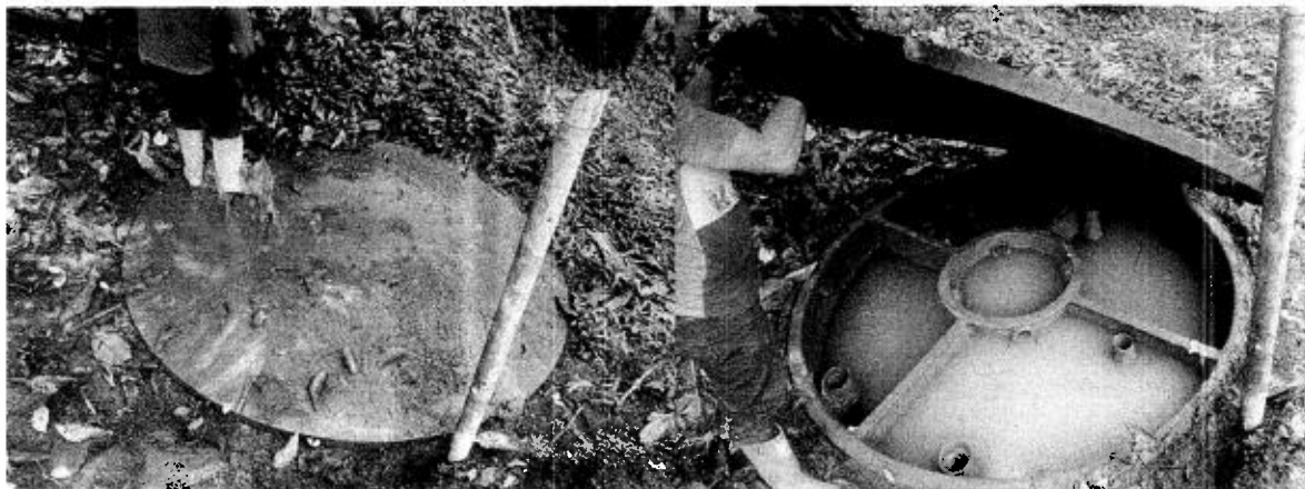
Foto 14 y 15. Unidad de tratamiento final del Lavadero Las Brisas No.2, trampa grasa
