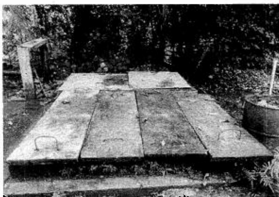
Foto 12. Unidad de pretratamiento, Lavadero Las Brisas No. 2.
