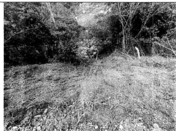
Imagen 10. Talud erosionado, depositando sedimentos al río Dormilón.
