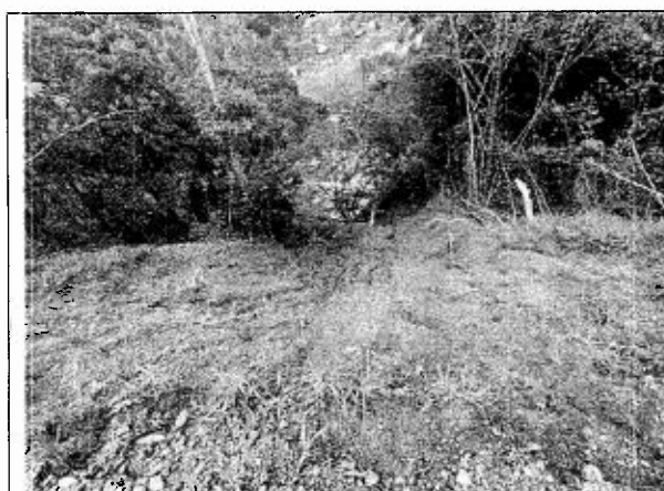
Figura 7. Talud cerca al río Dormilón, antes.
