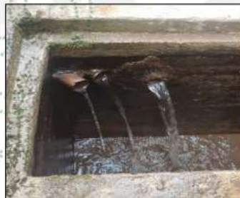
Figura 2. Entrada a tanque desarenador
