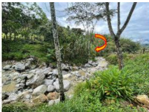
Proceso erosivo de tipo socavación (margen izquierda de la fuente)
