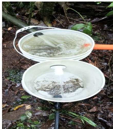
Sistema de control de caudal que cumple con los diseños entregados por Cornare, tapón perforado con broca 5/16 que garantiza el caudal otorgado, excedente a fuente por tubería de 2 pulgadas
