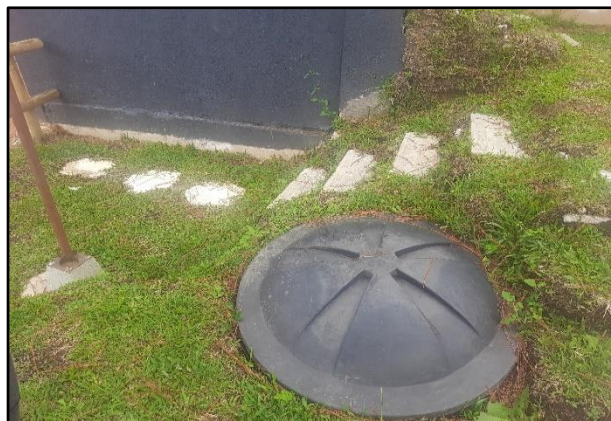
Ilustración 2. Sistema actualmente implementado en el predio.
