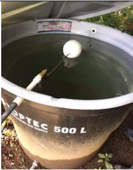
Imagen 2: Tanque Controlador de Flujo
