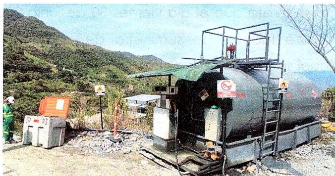
Figura 9. Zona de almacenamiento y suministro de combustible contratista Vías y Explanaciones Fuente: Cornare, 2023
