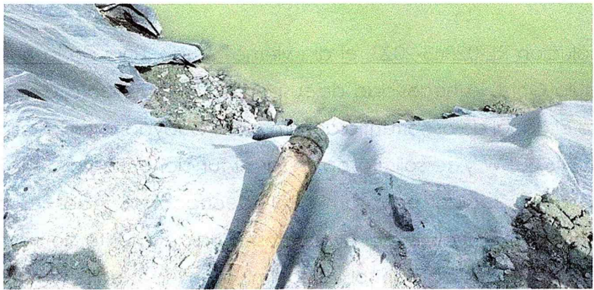
Figura 10. Conexión del tanque de salida de la PTARI hasta las pozas de contingencia Fuente: Cornare, 2023.
