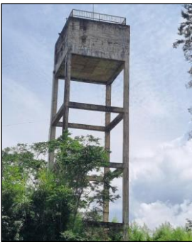
Imagen 10. Tanque almacenamiento (40000L)
