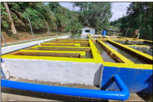
Imagen 9. Planta de tratamiento.
