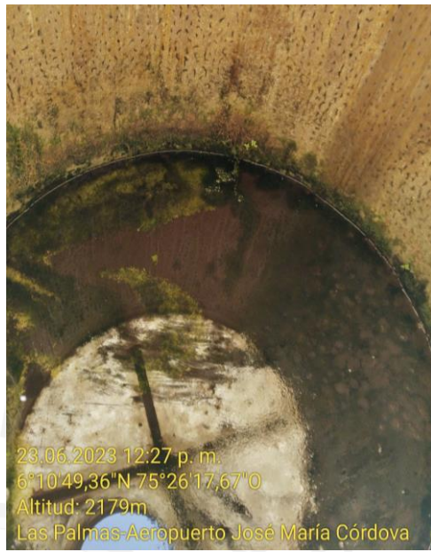
Fig. 2. Tanque de almacenamiento
