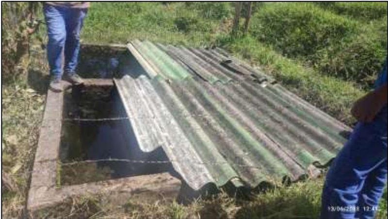
Figura 1. Tanque de almacenamiento
