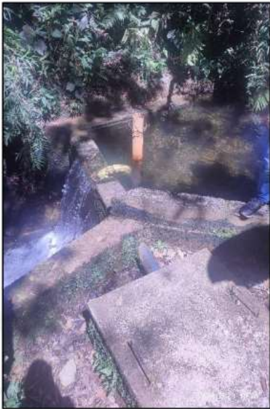
Figura 1. Punto de captación del acueducto
