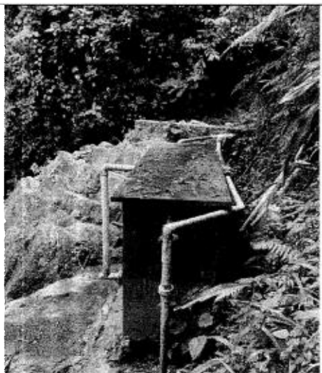
Imagen No. 2. Desarenador de la fuente hídrica Quebradona
