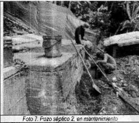
Foto 7. Pozo séptico 2, en mantenimiento
