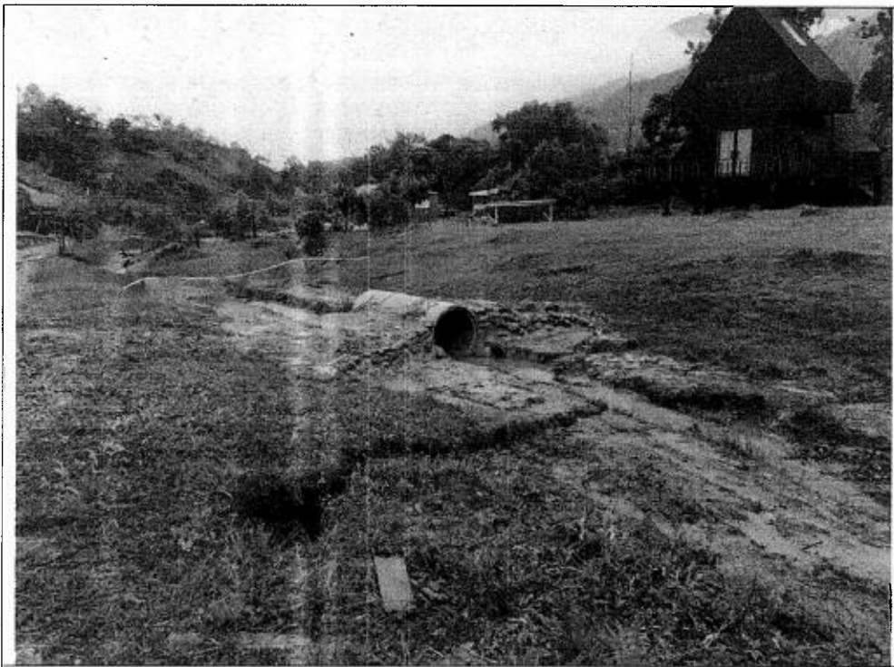
Figura 18. Atenor en concreto ocupando el cauce de corriente.
