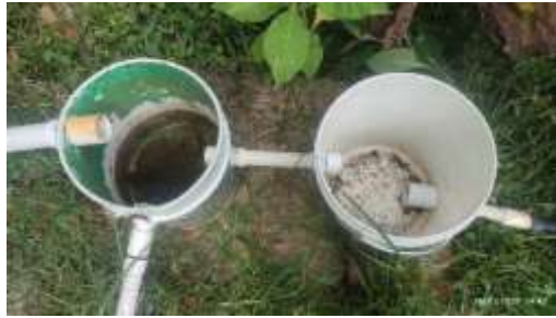
Figura 1. Obra de captación y control fuente Tinaja I
