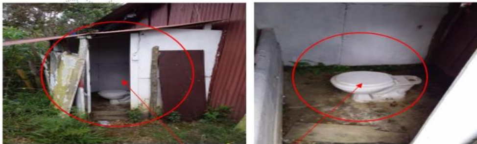
Figura 2: Imágenes de la unidad sanitaria en estado de abandono
