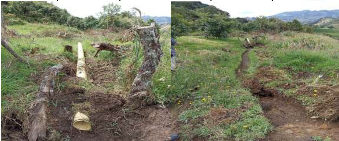
Tubería PVC instalada en la acequia que descarga en el nacimiento
