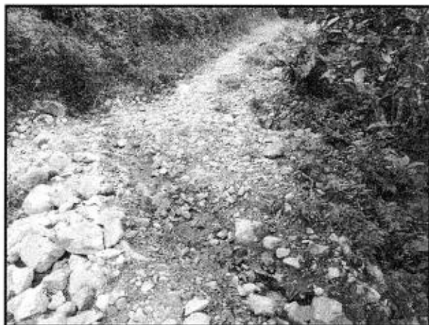
Imagen 5. Cornare. 2022. Escorrentía identificada sobre trayecto de la vía.
