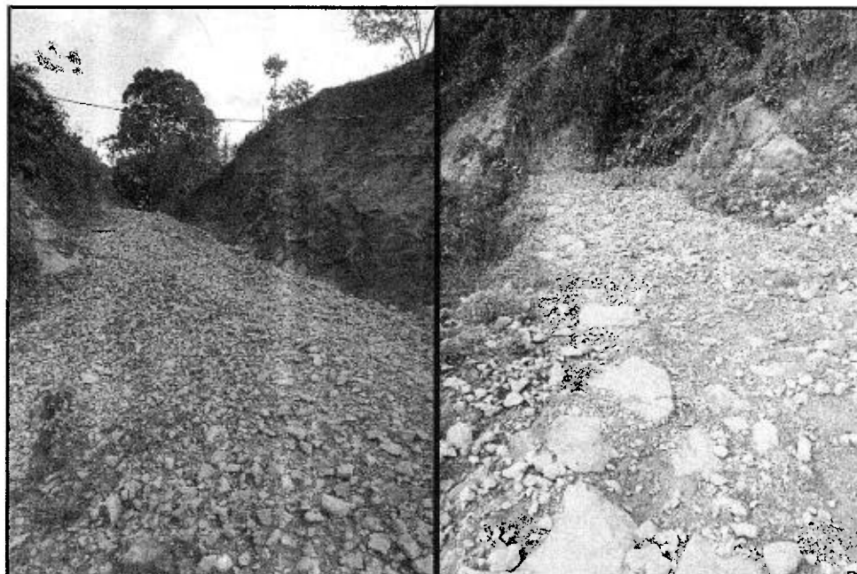
Imagen 1. Cornare. 2022. Estado de la vía aperturada al inicio del recorrido.
