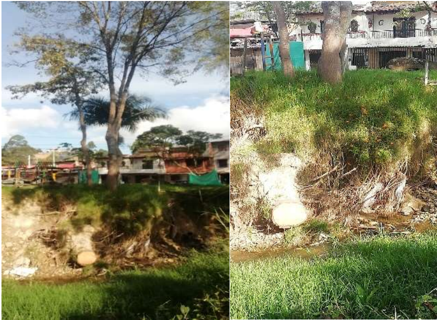
(imagen.) Árbol establecido sobre talud de la quebrada La Mosca
