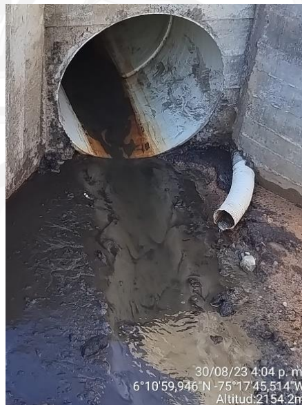
Ilustración 4. Descole de la obra (Tubería) NO autorizada
