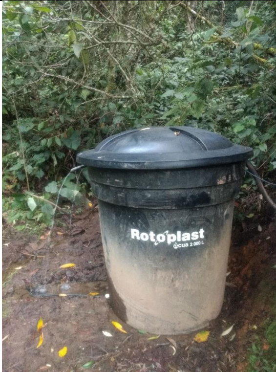
Tanque en material polietileno de 2.000 litros, instalado en el predio
