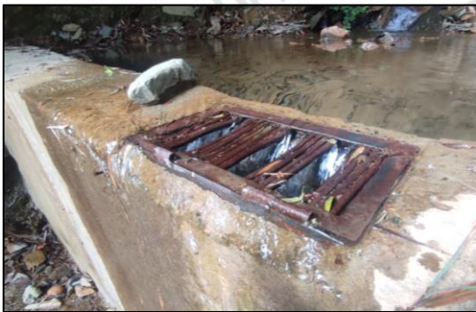
Figura 3. Rejilla de captación
