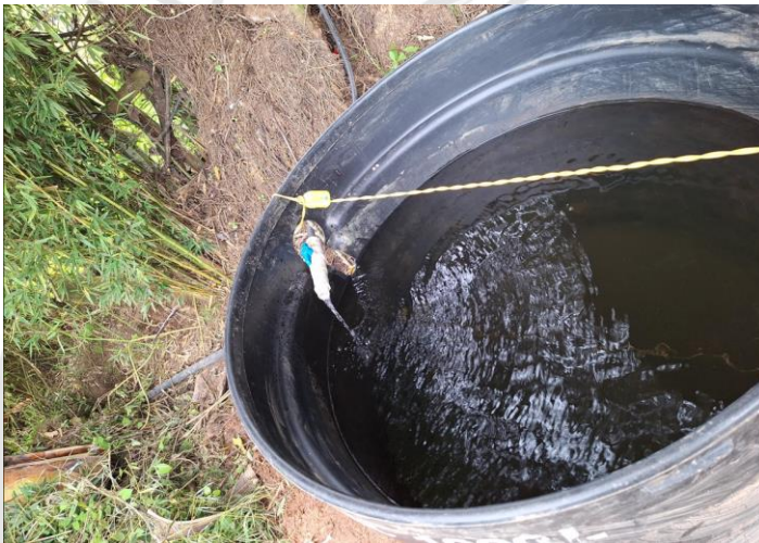
Imagen 4. tanque de almacenamiento Predio de Emma Suaza
