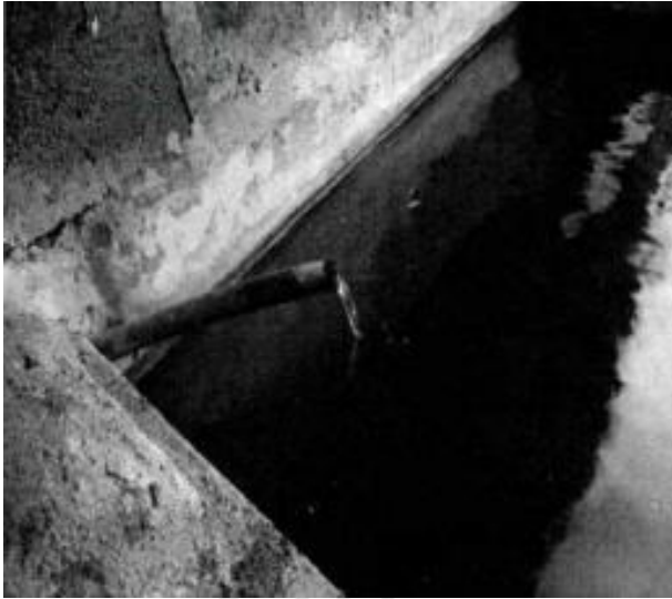
Imagen 3. Tanque de almacenamiento y distribución Predio de Rosalba Suaza.
