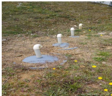
Imagen3. Sistema de tratamientos de aguas residuales.
