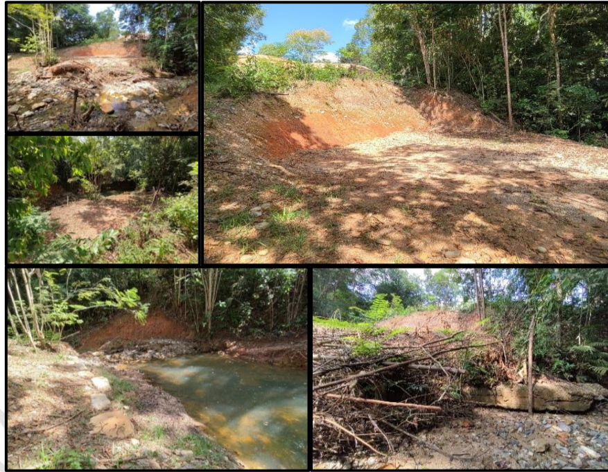
Imagen 1. Cornare. 2023. Explanación cercana a fuente hídrica con intervención de cauce.
