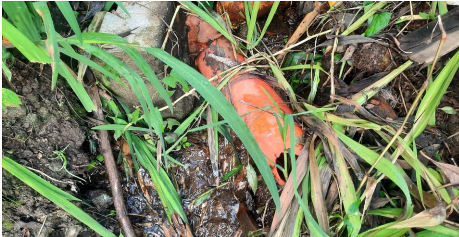
Tubería de descarga a fuente hídrica
