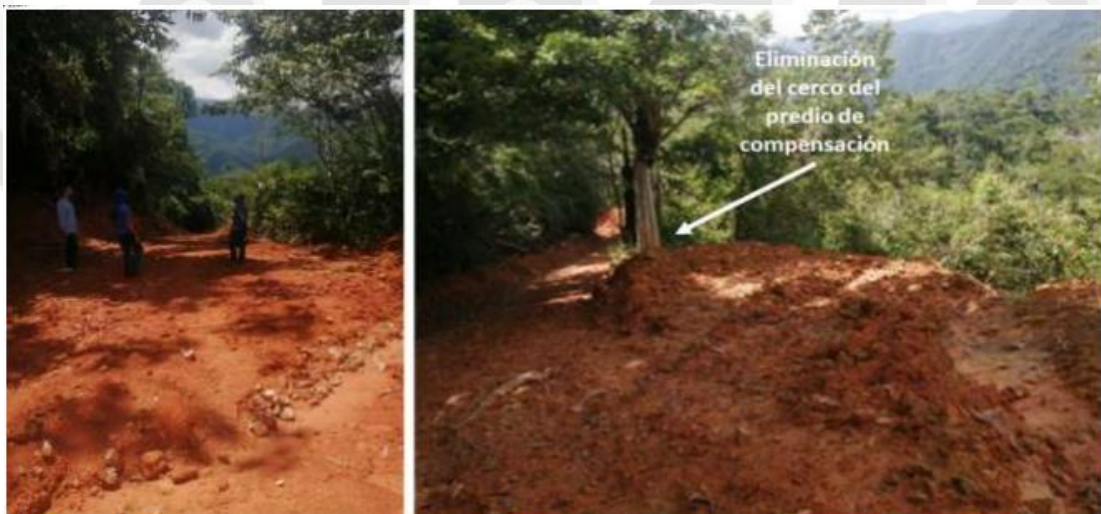
Figura 10. Área afectada por apertura de la vía en predio de compensación de la CH San Miguel, además de la eliminación del cerco del predio en la apertura de la vía. Fuente: CORNARE (14/08/2023)
