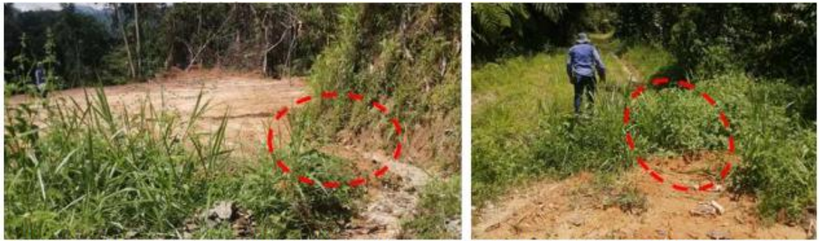
Figura 19. Obstaculización de material granular en obras de manejo de agua de escorrentía en la parte inferior del anterior deslizamiento Q14. Fuente: CORNARE (14/08/2023)
