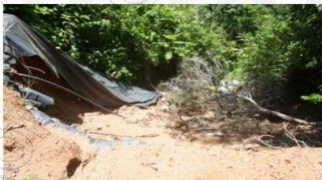
Figura 21. Tala de árboles y daño en obra de estabilización entre los predios de los señores Teodomiro Salazar y Elgar Galeano. Fuente: CORNARE (14/08/2023)
