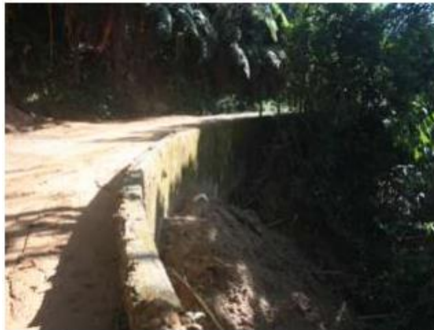
Figura 5. Taponamiento de material de deslizamiento de la captación del señor Teodomiro Salazar. Fuente: CORNARE (14/08/2023)
