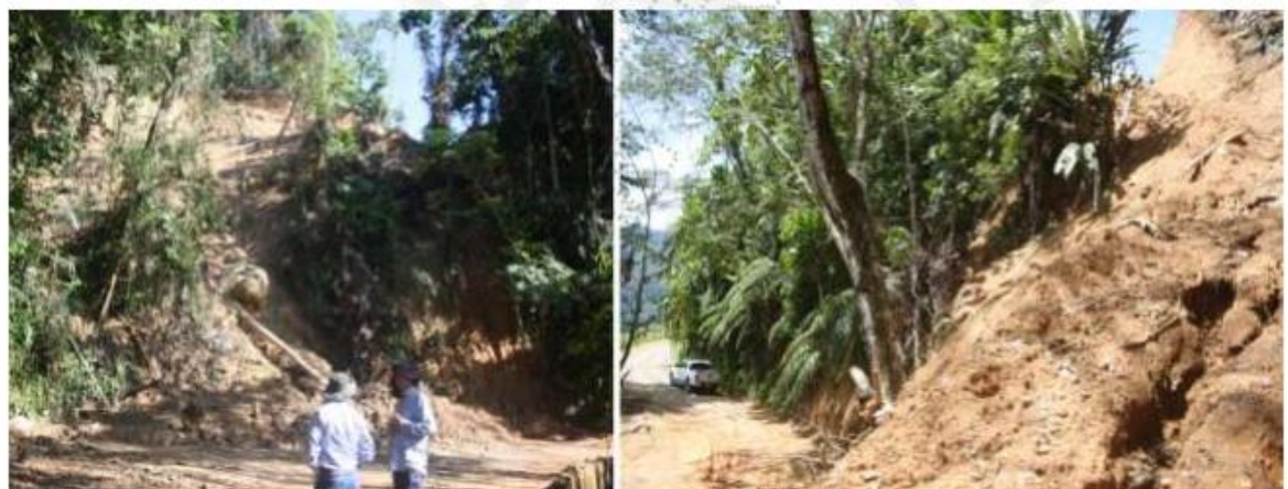
Figura 4. Deslizamiento 1, que es el inicio de la vía sin permiso desde la vía a casa de máquinas de la CH San Miguel. Fuente: CORNARE (14/08/2023)
