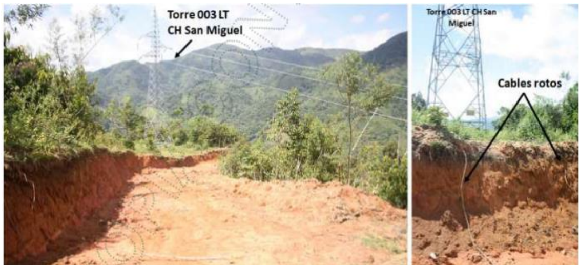
Figura 11. Distancia entre la apertura de la vía sin permiso para la torre 003 de la línea de transmisión de la CH San Miguel y rotura de cables de ésta. Fuente: CORNARE (14/08/2023)
