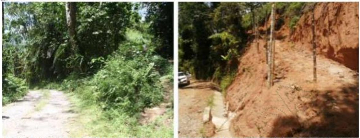
Figura 22. Punto de partida de la vía y punto de finalización desde la vía sin permiso paralela a casa de máquinas. Fuente: CORNARE (14/08/2023)
