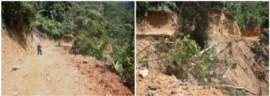
Figura 8. Suelo y árboles en talud de la vía sin permiso. Fuente: CORNARE (14/08/2023)
