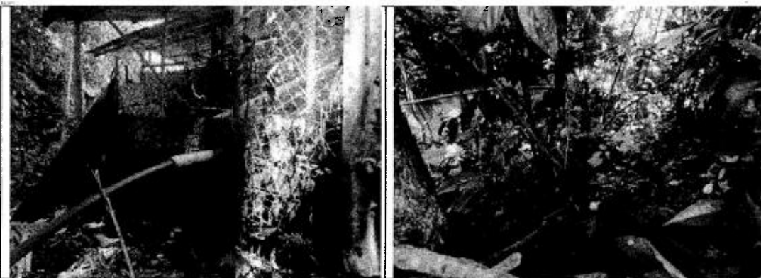
Imagen 3. Tubería de descarga de aguas residuales no domésticas (porcícola)
