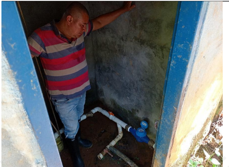
Imagen 1: Sitio de donde se extrae el agua – Pozo profundo, ubicado en el predio El Manantial.
