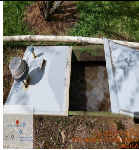
Sistema de Aireación
