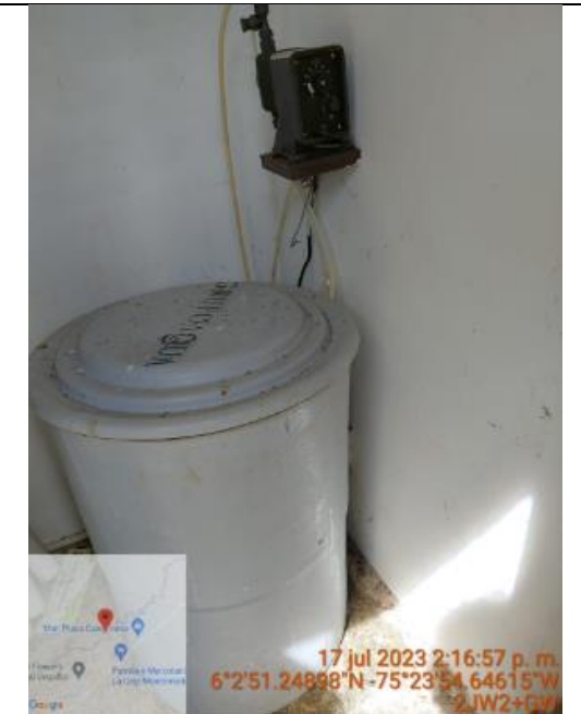
Sistema dosificador de Cloro
