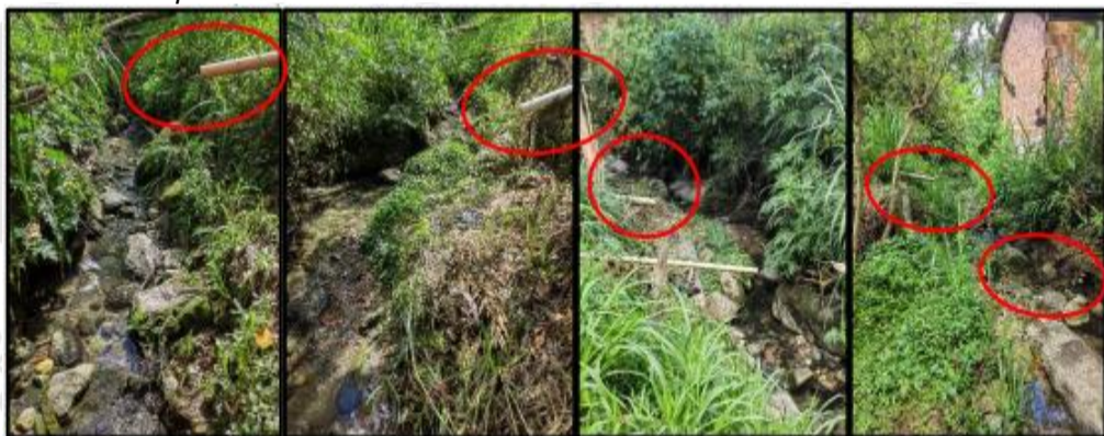
Imagen 2. Cornare. 2023. Tuberías tipo PVC que descargan a fuente hídrica.
