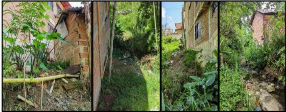
Imagen 3. Cornare. 2023. Viviendas del sector La Granja que ocupan parte de la Ronda Hídrica de la Quebrada La Granja.
