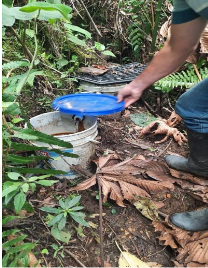
Sistema de control de caudal en la fuente Cartagena que cumple con los diseños entregados por Cornare,
