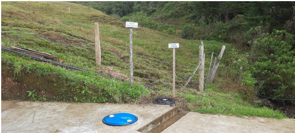
Pozo de desactivación sin derrames o excedentes Se almacena y se dispone adecuadamente sin generar vertimiento
