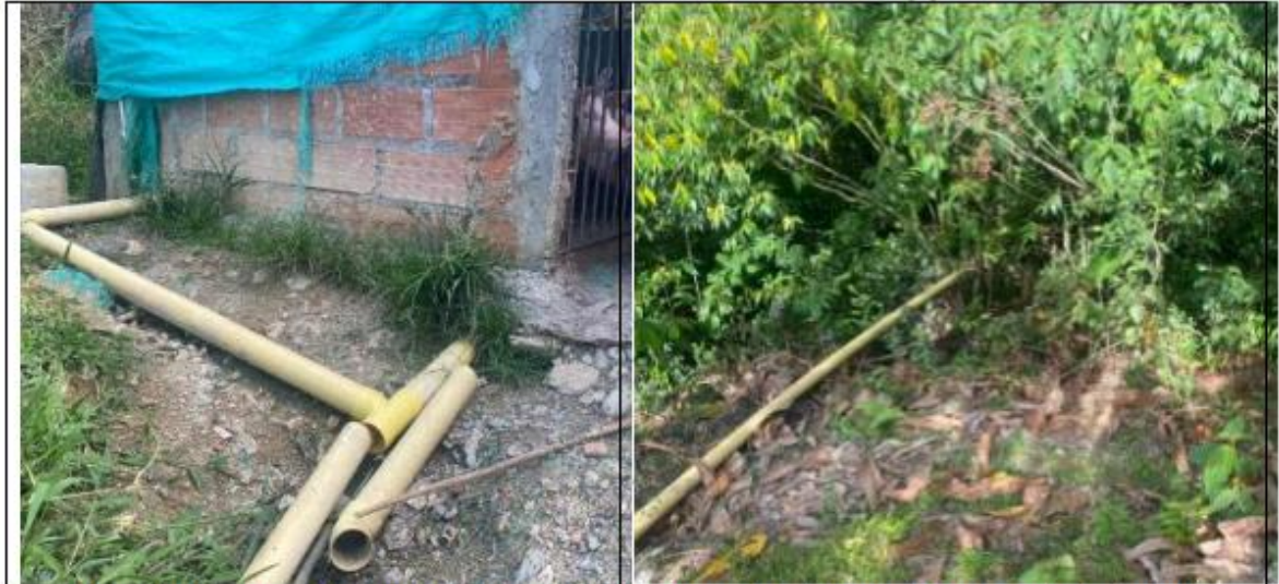
Fotografías 3 y 4. La descarga va directamente a la quebrada Santo Domingo sin tratamiento previo
