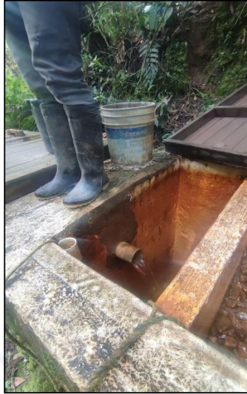
Figura 2. Caudal de entrada al tanque desarenador
