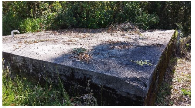
Tanque de Almacenamiento
