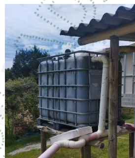
Imagen2. Tanque almacenamiento Aguas Lluvias.
