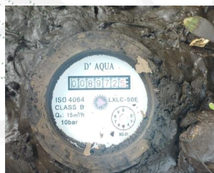
Imagen4. Medidor de caudal.
