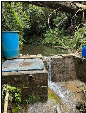
Figura 1. Punto de captación
