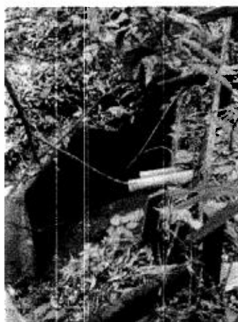
Foto 3. Descarga sin tratamiento de las aguas generadas en los servicios de lavado y cocina del Hotel Monteloro
