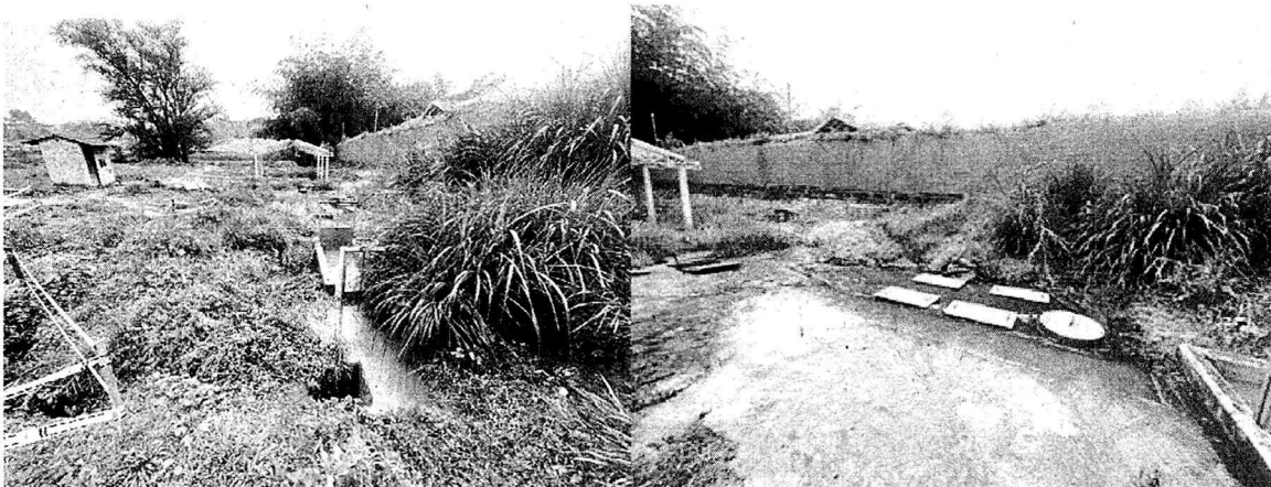
Unidades de la PTAR inundadas y fuera de operación y sin rocería y paisajismo en sus alrededores
