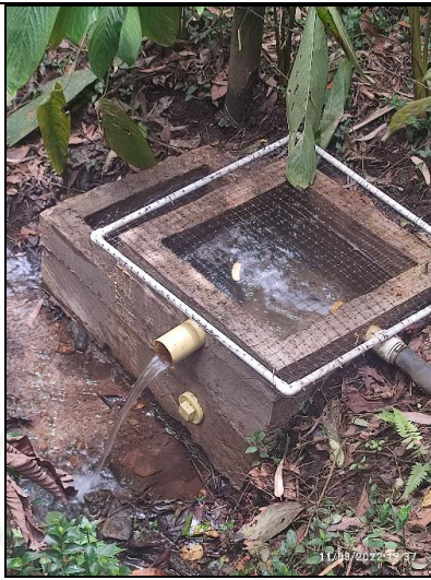
Figura 2. Obra de captación fuente La Nevada
