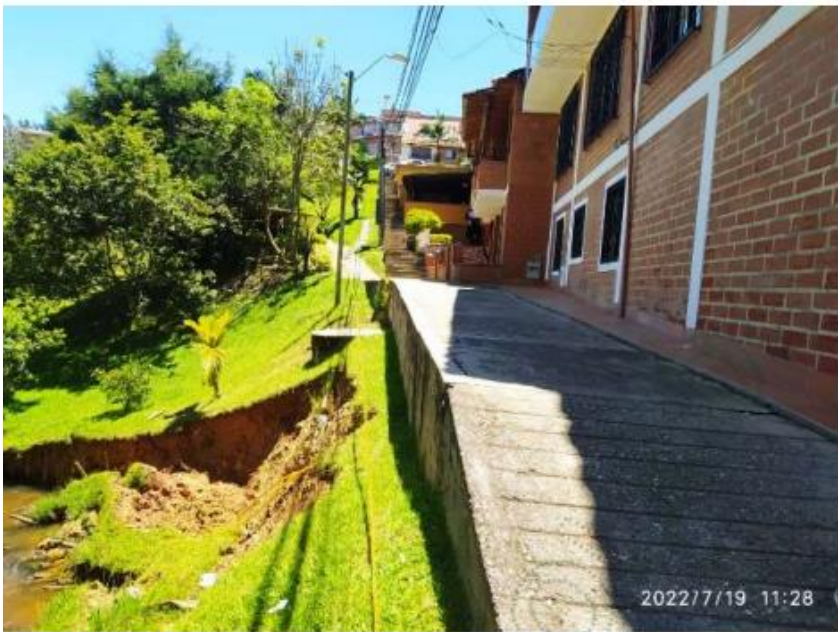
Figura 3. Vivienda en riesgo por cercanía al deslizamiento. Cornare, 2022.
