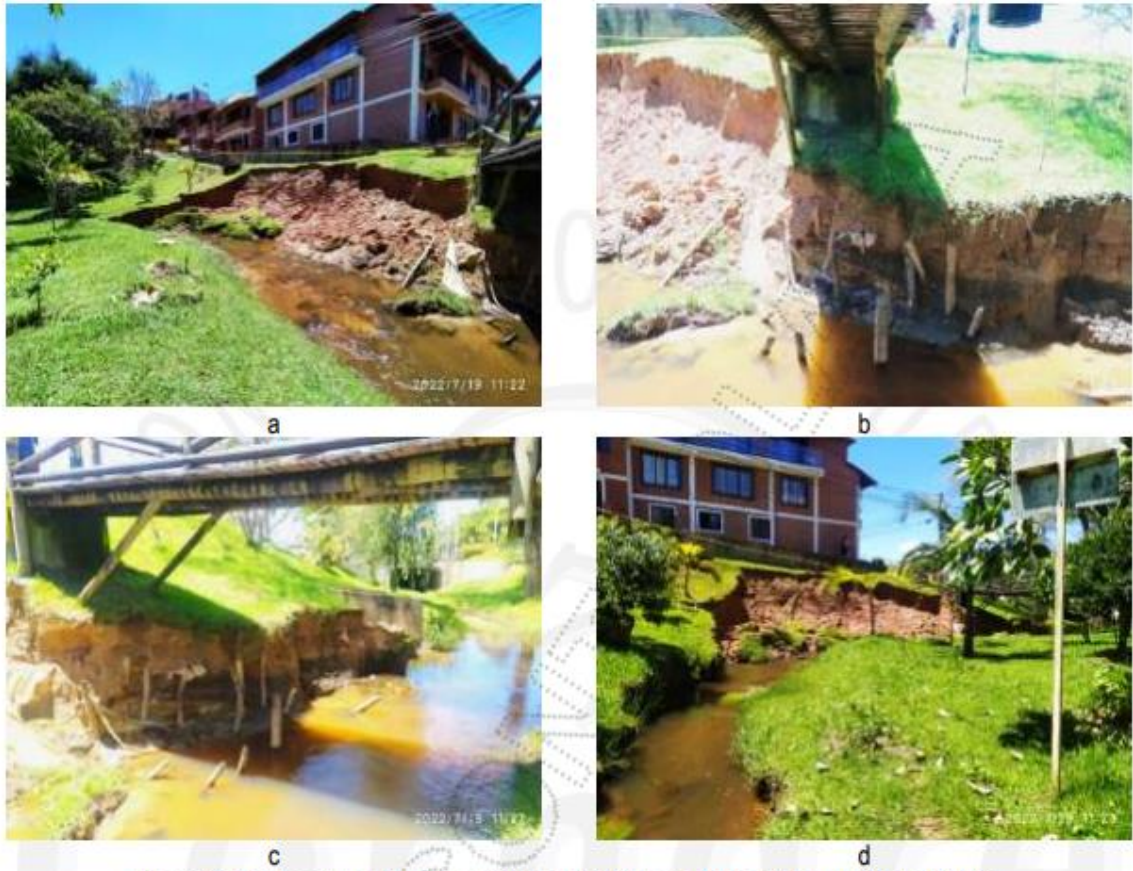
Figura 2. Talud colapsado margen izquierda Quebrada Abreo Malpaso. Cornare 2022.
