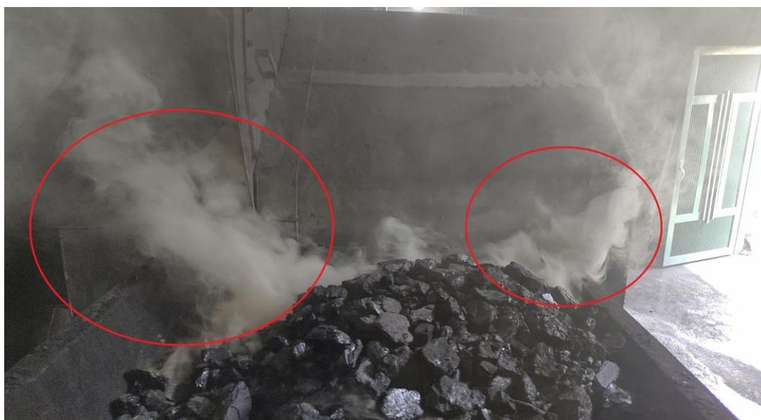
Imagen 4. Emisión de humo en tolva alimentación caldera 80 BHP.
