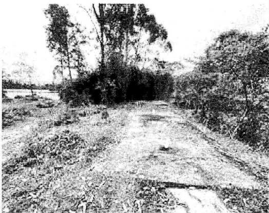
PTAR carente de cerco en alambre
