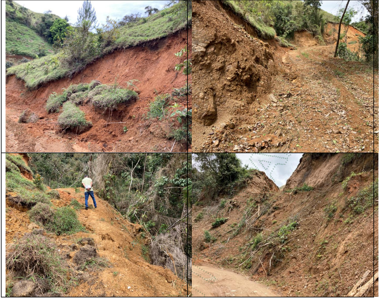
Imagen 1. Procesos erosivos, desprendimientos y taludes con alturas superiores a 3 m
