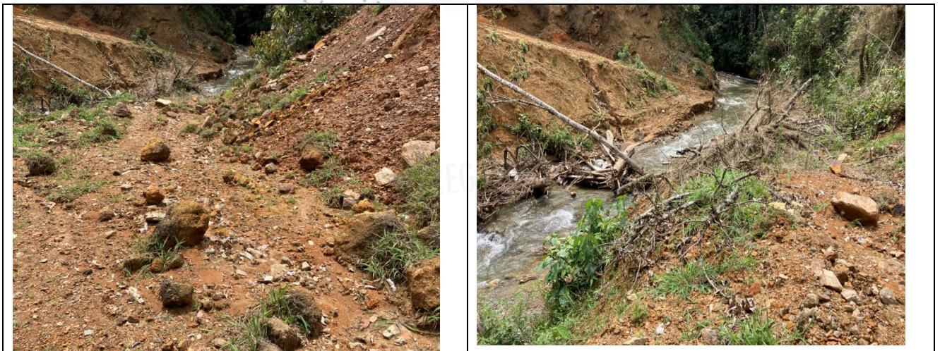
Imagen 2. Material caído y arrastrado a la fuente
