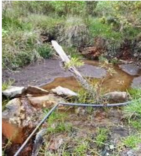
Fotos 3: Captación en la fuente de agua La Frontera en el predio con PK 7562001000000400004
