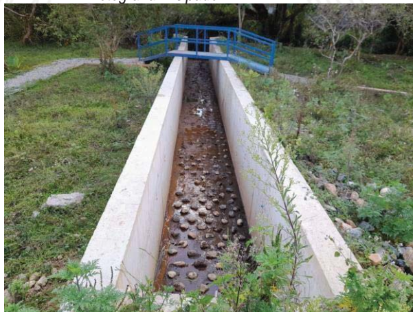
Fotografía Disipador BT1:
