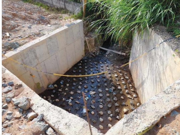
Fotografía Disipador BT4:
