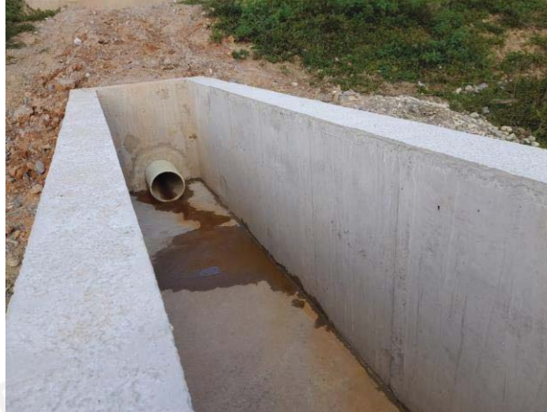
Fotografía Estructura de descarga PTAR:
