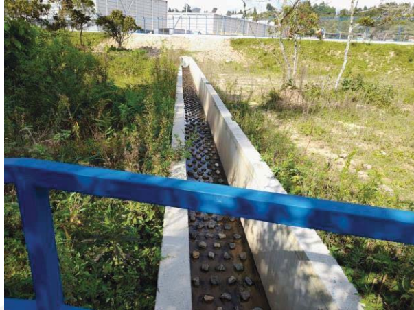
Fotografía Disipador BT3:
