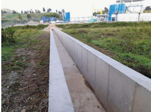
Fotografía disipador PTAR:
