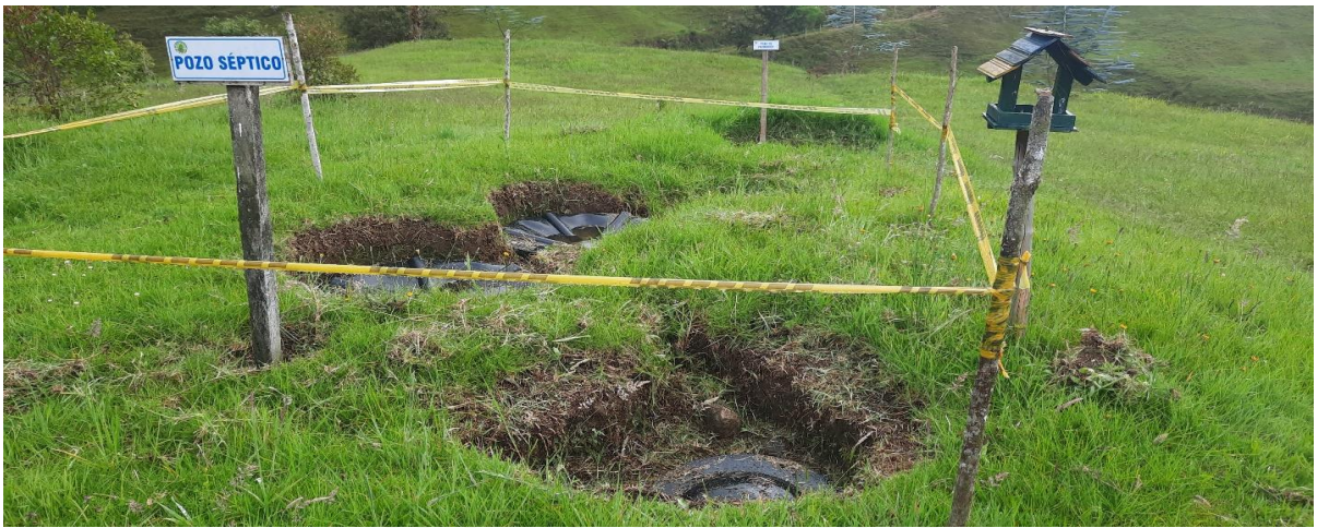
Pozo séptico Instalado en uno de los sitios referenciados
