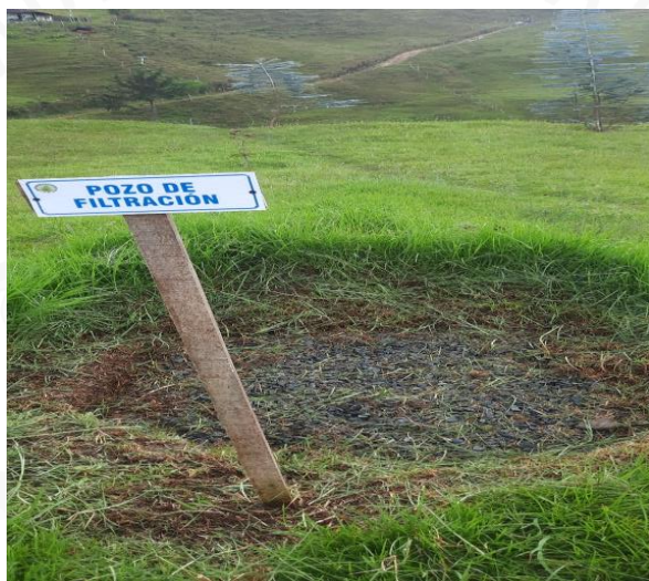
Sistema de infiltración
