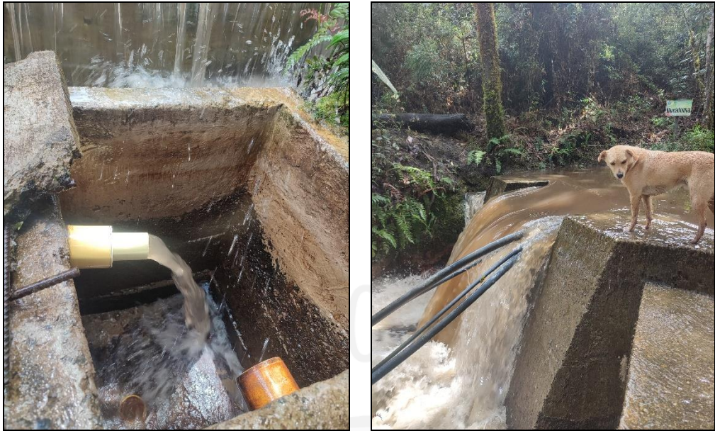
Figura 1. Control de caudal y Punto de captación
